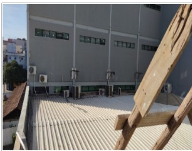
Foto 9: Telhado acima do plenários - serviço de substituição de calhas, rufos e limpeza.
