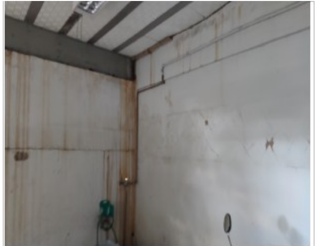
Foto 6: Infiltração causada por falha do atual sistema de impermeabilização
