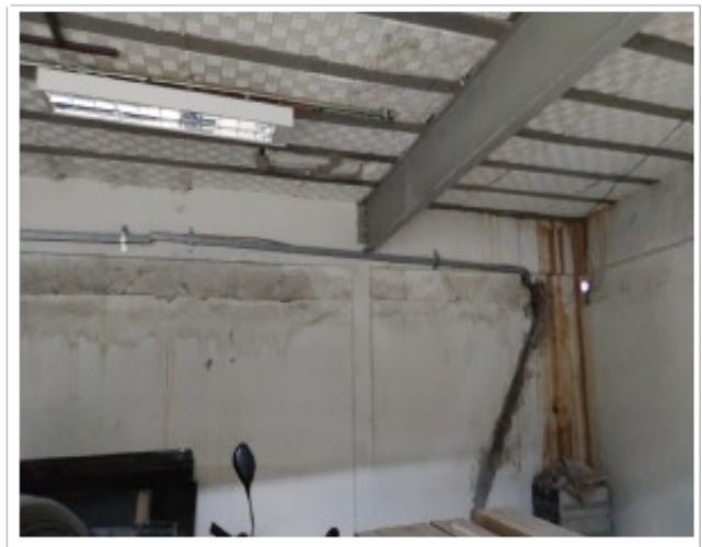
Foto 8: Infiltração causada por falha do atual sistema de impermeabilização.
