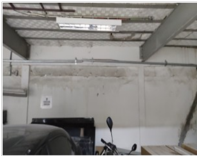
Foto 7: Infiltração causada por falha do atual sistema de impermeabilização.
