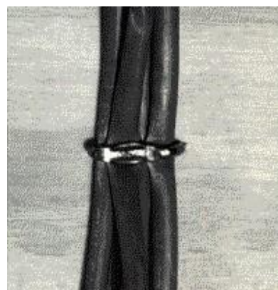
Figura 2 - Cabo amassado (incorreto)
